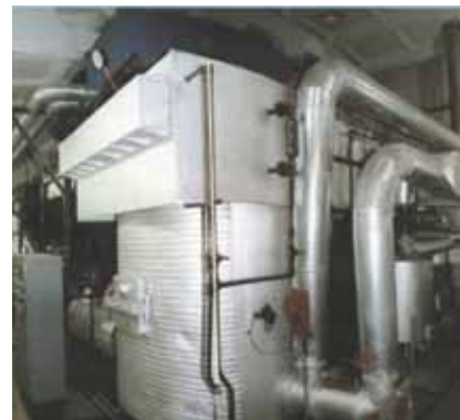
Лаборатория с котлами кипящего слоя
