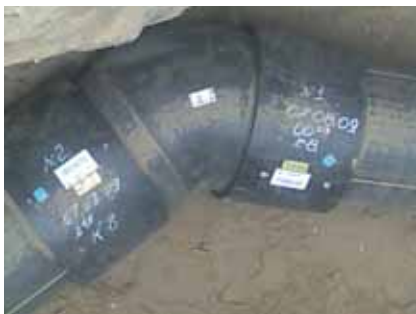
Рис. 6. Нарушение при сборке соединения. Превышено расстояние между стыками свариваемых труб \varnothing 225 мм внутри левой муфты
