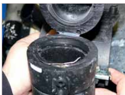
Рис. 4. Нарушение при сборке соединения. Стык свариваемого патрубка седлового отвода и трубы Ø 63 мм попал в горячую зону муфты
