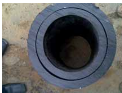
Рис. 8. Превышение максимально допустимого зазора между «просаженной» трубой \varnothing 250 мм и муфтой с ЗН
