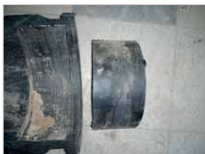
Рис. 3. Нарушение технологии подготовки труб Ø 250 мм к сварке. На внешней поверхности куска трубы справа отсутствуют следы механической обработки
