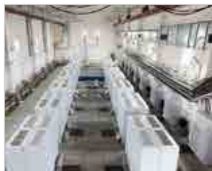
Рис. 14. Люберецкие ОС. Отделение установки модулей УФ-обеззараживания
