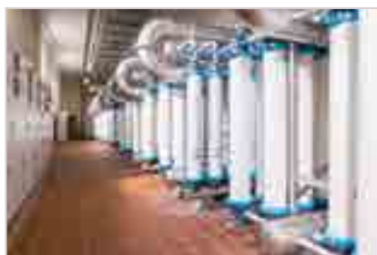
Рис. 2. Юго-Западная водопроводная станция. Мембранный блок
