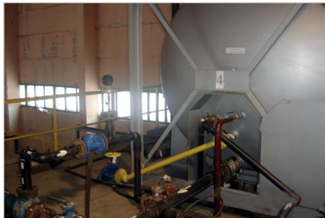
Оборудование блока сорбционной обработки воды
