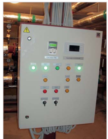
Щит управления ИТП KV Electro. TS.2.POL638
