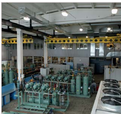
Производственный цех «ТЕРМОКУЛ»
