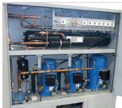
Холодильный агрегат с тремя спиральными компрессорами
