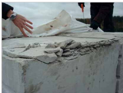
Рис. 4. Повреждение блоков стропами при разгрузке поддонов
