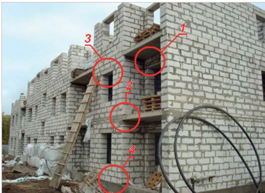
Рис. 1. Теплопроводные включения в оболочке строящегося жилого дома: 1 — сопряжение балконной плиты с наружной стеной; 2 — сопряжение междуэтажного перекрытия с наружной стеной; 3 — оконная перемычка; 4 — сопряжение наружной стены с цоколем
