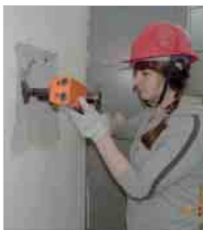
Рис. 4. Определение остаточной прочности бетона шахты генератора Воткинской ГЭС методом отрыва со скалыванием прибором ОНИКС-1.ОС.100
