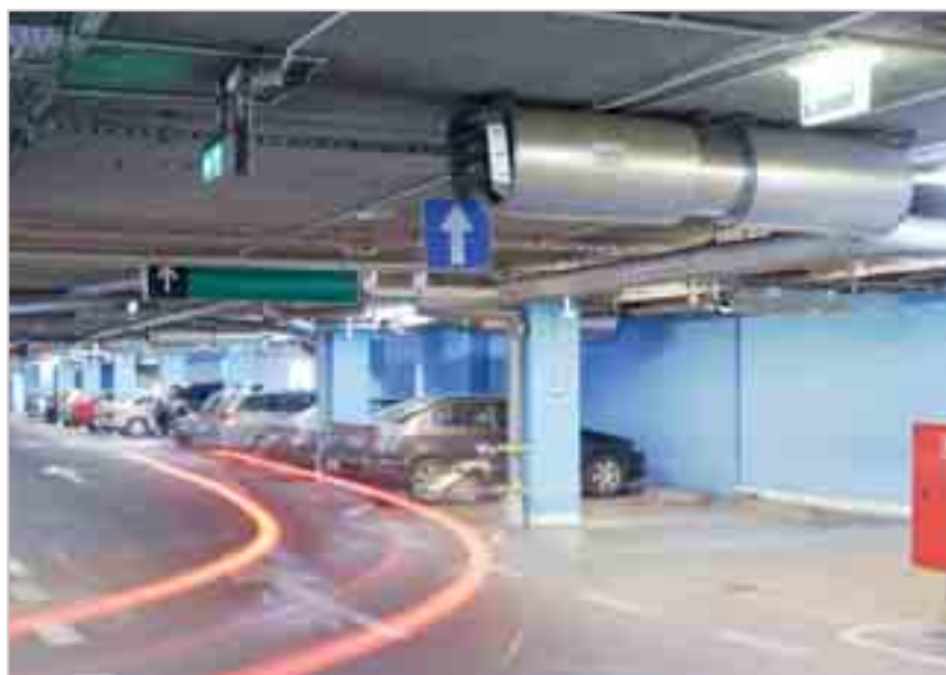
Крытая автостоянка оборудована системой струйной вентиляции
