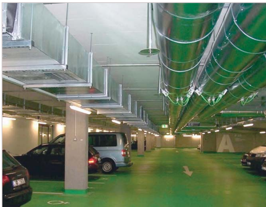
Рис. 1. Современная подземная автостоянка, оснащенная канальной противодымной вентиляцией
