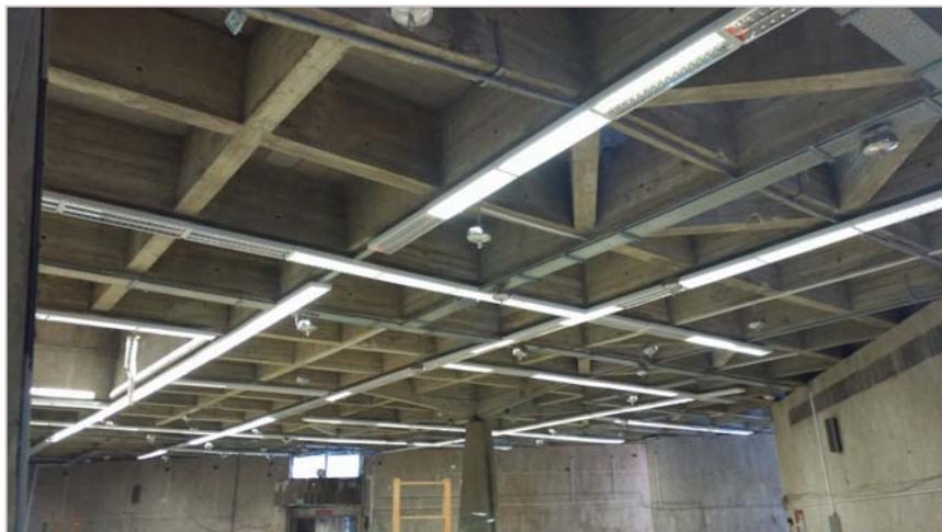
Фото 1. Существующая система автоматического пожаротушения на объекте
