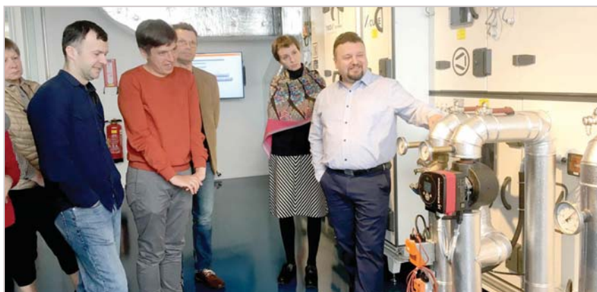
Приточно-вытяжная установка в Опытном центре Belimo
