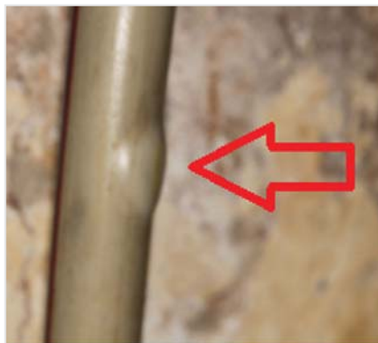
Рис. 5. Образование «отдулин» (указано стрелкой) на поверхности трубопроводов после двух лет эксплуатации. На этом месте произойдет разрушение конструкции
