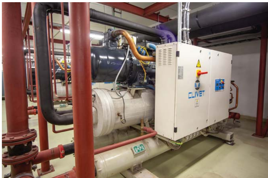
Охлаждающее оборудование (чиллеры) фондохранилища дает возможность максимально бережно провести акклиматизацию экспонатов
