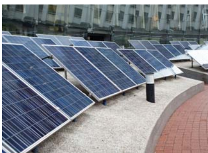
97 солнечных панелей общей мощностью 20 кВт могут обеспечить освещение административного корпуса
