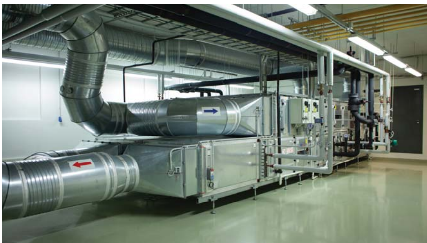
Мощные вентиляционные установки фондохранилища рассчитаны на переработку 800 тысяч кубометров воздуха в час
