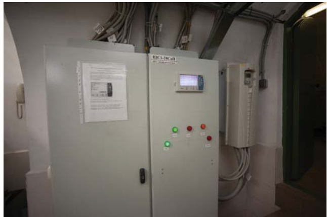
Установки для частотного регулирования двигателей вентиляционных систем значительно снижают энергозатраты на воздухообмен
