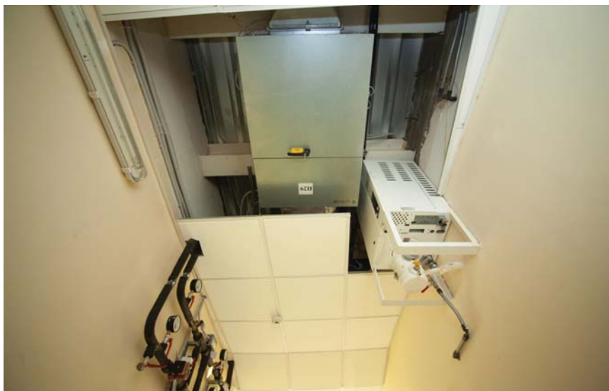
Для реставрационной лаборатории темперной живописи, где особенно важен температурно-влажностный режим, за потолочной панелью установлены основная и резервная вентустановки с парувлажнением и роторным рекуператором
