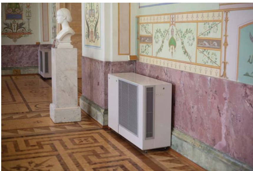
Доводчики в музейных залах позволяют снизить скорость подаваемого по каналу из подвала воздуха до нормируемых требований
