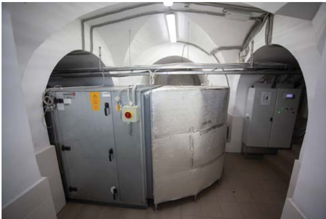
Одна из крупнейших вентиляторных установок Эрмитажа на 30 тысяч кубометров с трудом помещается в подвальном техническом помещении
