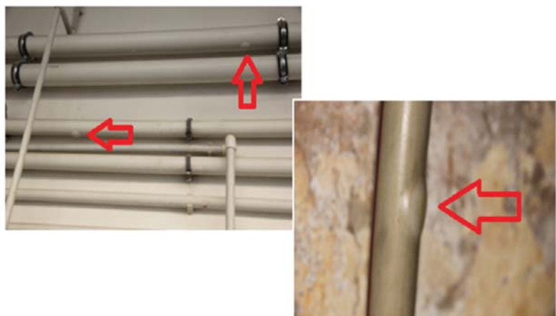
Рис. 9. Вид разрушений пластиковых конструкций в системах теплоснабжения ремонтных предприятий
