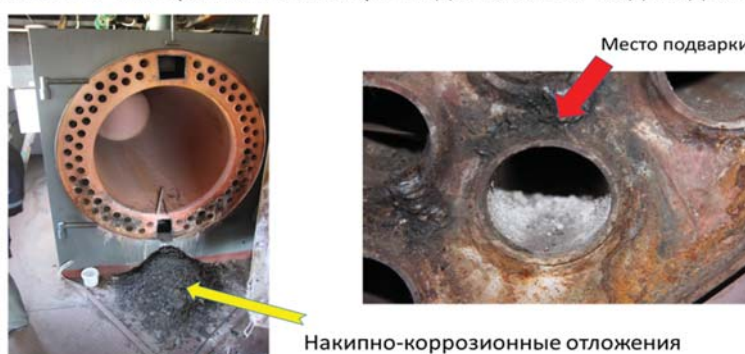
Рис. 20. Состояние внутренней поверхности парового котла в случае недостаточной водоподготовки
