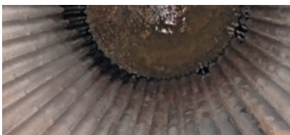
Рис. 10. Состояние 1-го котла на момент заключения договора
