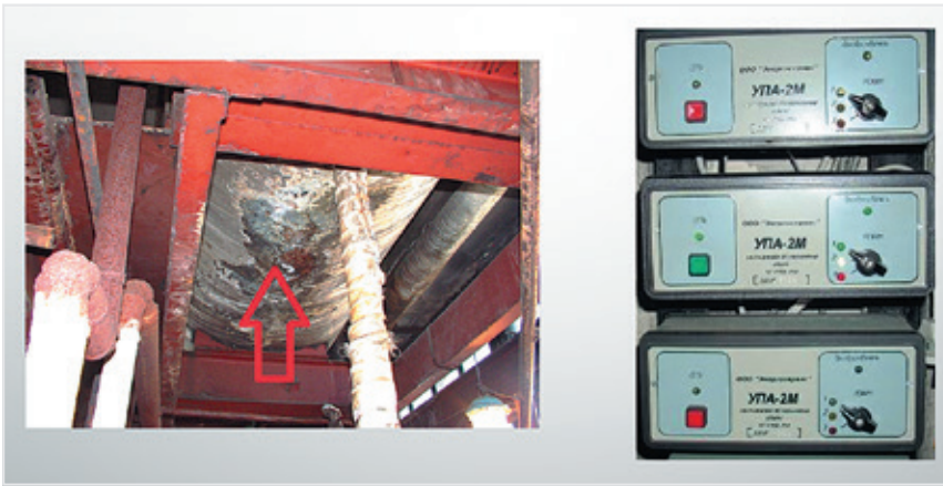
Рис. 2. Ультразвуковые приборы УПА-2М. Коррозионные повреждения деаэратора в депо при использовании ультразвукового метода
