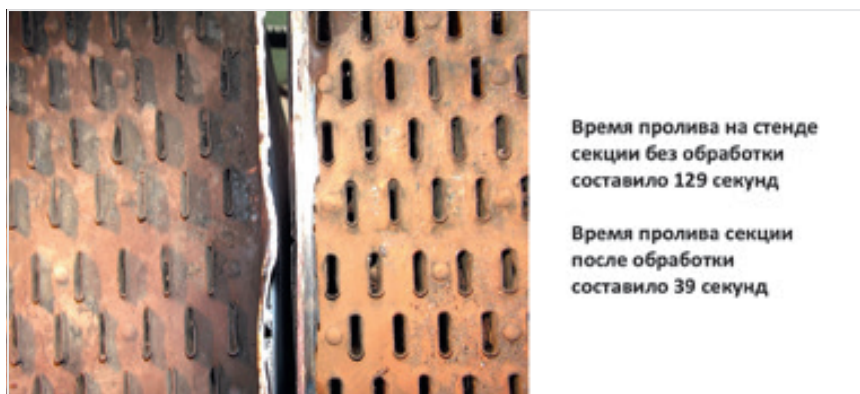
Рис. 12. Состояние секций холодильника до и через год после ЭМВ
