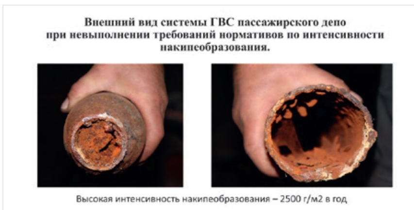
Рис. 7. Коррозийно-солевые отложения в трубах сетей ГВС
