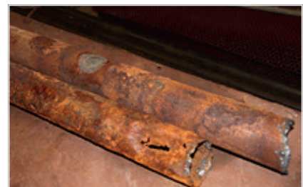
Рис. 5. Состояние сетей ГВС транспортного комплекса. Коррозионные повреждения с наружной стороны, подварки
