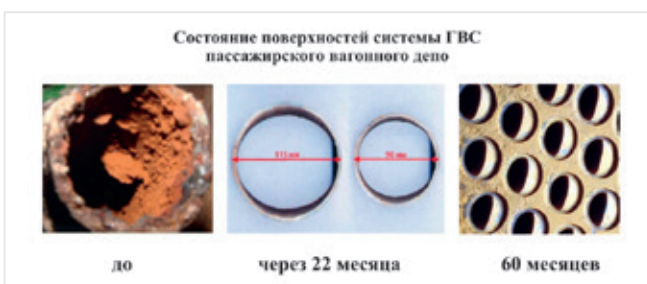
Рис. 19. Состояние поверхностей системы ГВС пассажирского вагонного депо: а) до обработки; б) после обработки (через 22 месяца); в) после обработки (через 60 месяцев)
