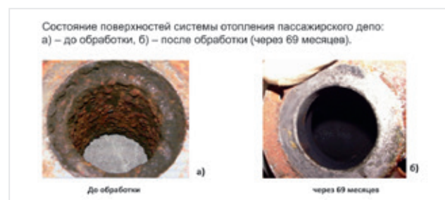
Рис. 20. Состояние поверхностей системы отопления пассажирского депо: а) до обработки; б) после обработки (через 69 месяцев)
