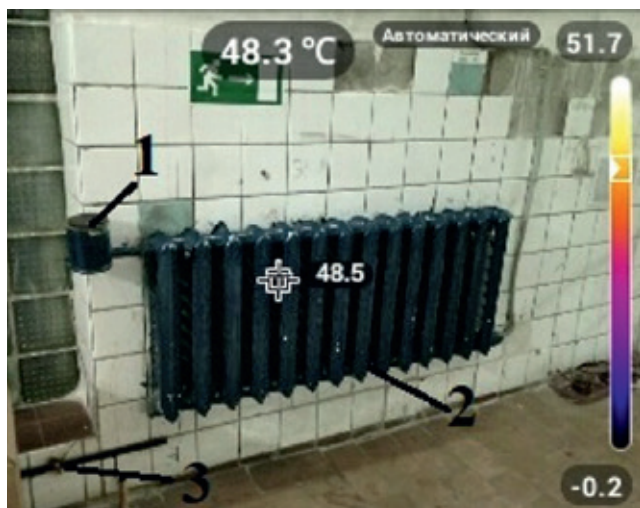
Рис. 3. Внешний вид отопительного прибора в машинном зале низковольтной КНС: 1 — электрический блок нагревателя; 2 — секции чугунного радиатора; 3 — заземление
