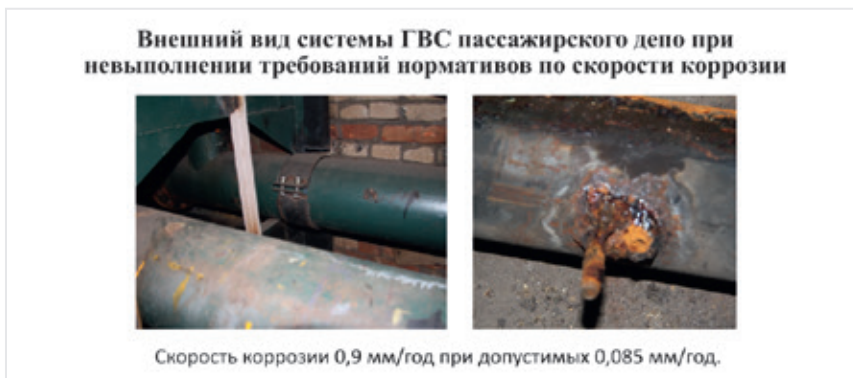
Рис. 6. Сквозные язвенные повреждения: хомут на корпусе подогревателя ГВС и подварка «свища» на трубопроводе ГВС
