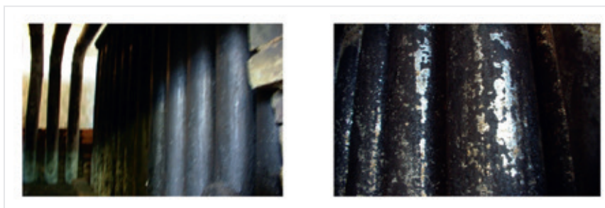
Рис. 14. Состояние топки котла, не работающего в момент его обработки с применением энергетического метода водоподготовки (слева). Состояние топки котла, работающего в момент его обработки энергетическим методом водоподготовки (справа)
