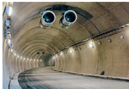
Рис. 2. Автодорожный тоннель, оснащенный струйными вентиляторами
