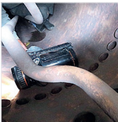
Рис. 7. Состояние барабана парового котла через девять месяцев после ЭМВ
