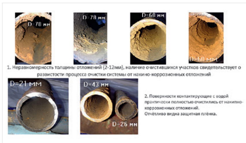
Рис. 12. Состояние трубопроводов системы теплоснабжения через десять месяцев после обработки энергетическим методом
