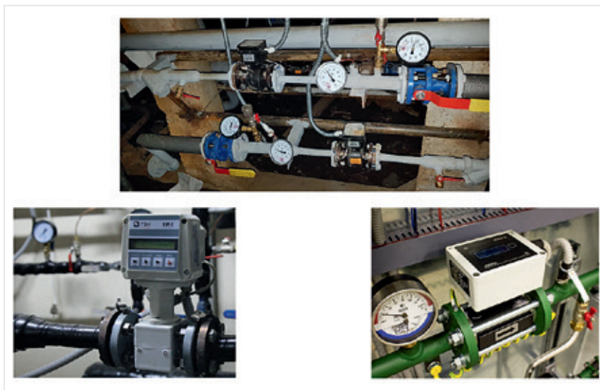
Рис. 15. Компоненты тепломеров (датчиков расходов и температуры, тепловычислители) на трубопроводах системы ГВС и сетях О + В
