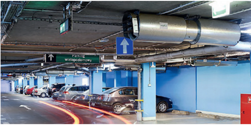
Рис. 1. Подземная автостоянка, оснащенная струйными вентиляторами
