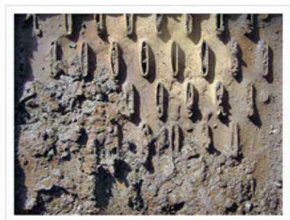
Рис. 19. Состояние системы водоохлаждения дизеля тепловоза
