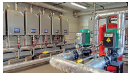
Рис. 2. Энергоэффективная газовая котельная с котлами NAVIEN
