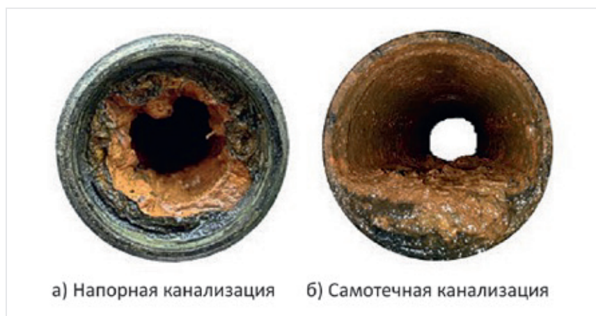
Рис. 3. Общий вид отложений в напорных и самотечных канализационных сетях
