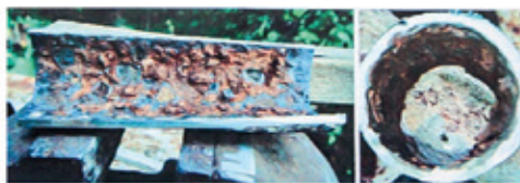
Рис. 4. Коррозионные разрушения стыковочных соединений при сроке службы более 70 лет
