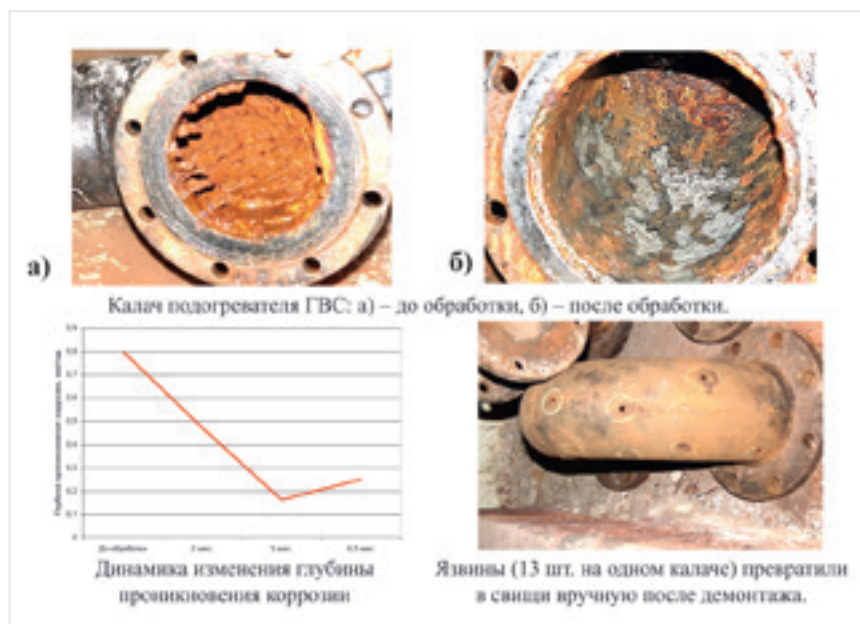
Рис. 15. Затягивание сквозных коррозионных разрушений диаметром 5–7 мм
